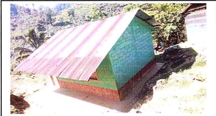
Foto 1. Se observa el deterioro de las láminas.
