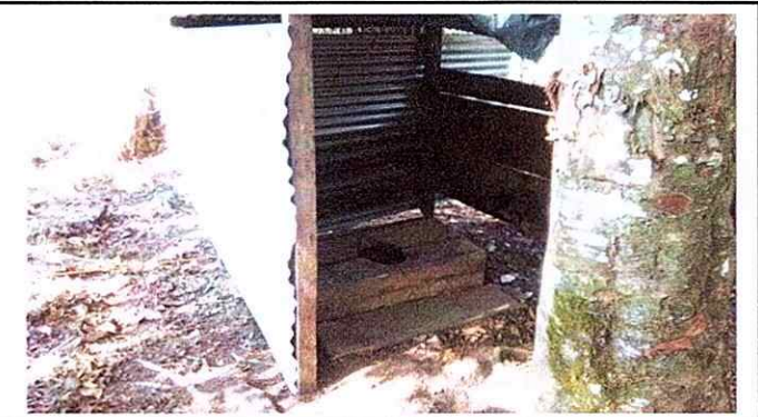
Foto. Se observa el baño en mal estado.
